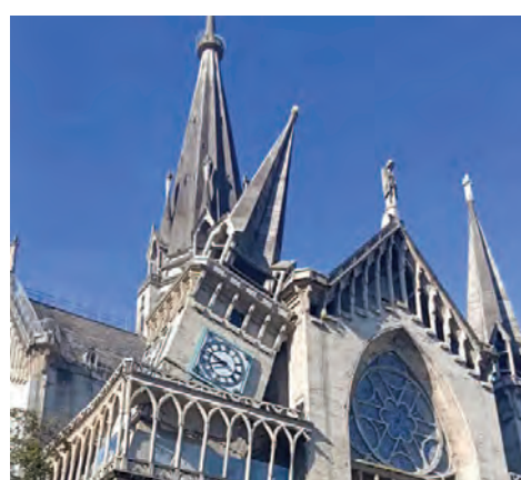
La Catedral de la ciudad de Manizales, se especula que tendrá que ser demolida debido a graves daños estructurales.
