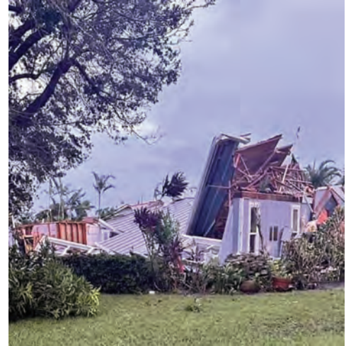
Milton fue un explosivo y destructor huracán.
