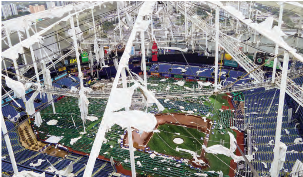
La furia del huracán Milton destruyó el techo del estadio Tropicana Field.
