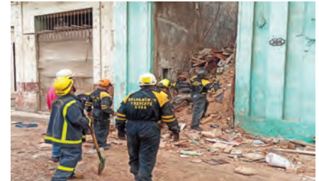
Un grupo de rescatistas, al atender el derrumbe de una edificación en La Habana (Cuba). EFE/Ernesto Mastrascusa.
