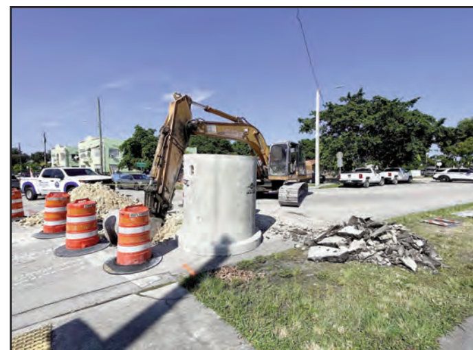
En el sector de la Calle 5 y la Avenida 32 del SW se trabaja en los desagües de agua de lluvia.
